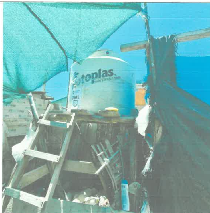
FOTO 03. - Vista uso de tanques elevados con suministro de tanques cisterna de agua potable.
