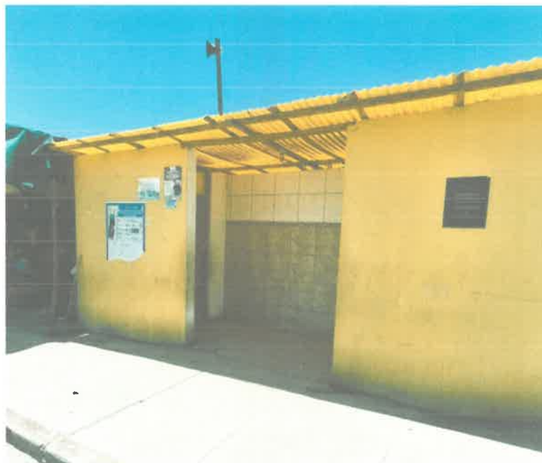
Vista de la batería de SSHH de Damas y Varones clausurado por falta de mantenimiento
