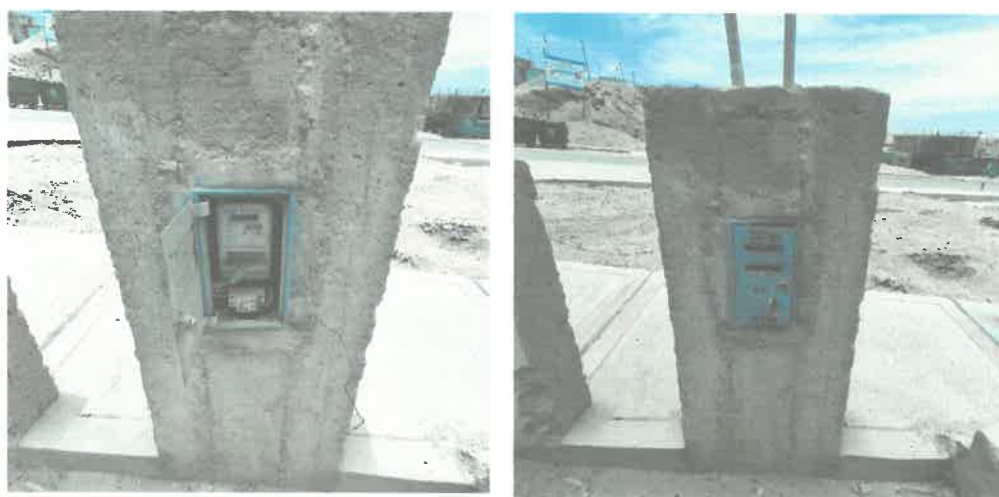
Vista del Medidor de energía eléctrica de la Asociación
