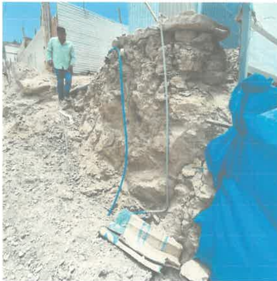
Vista de la ubicación del medidor de agua potable como punto de distribución para toda la Asociación.
