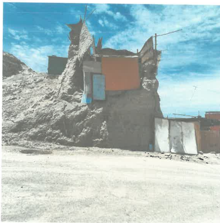
Foto 3: Vista del predio ubicado en el Lote 10 en situación de riesgo alto y sin accesibilidad desde la Calle 07.
