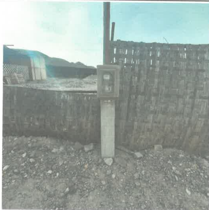
Foto 3: Vista de los medidores domiciliarios de suministro eléctrico provisionales en los lotes de la Asociación.
