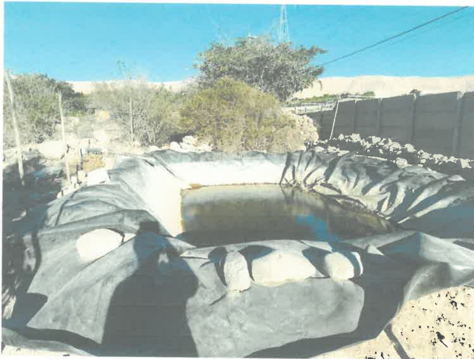
Foto 9 : Vista del geotanque de acopio de agua de regadío en la Asociación El Oasis.
