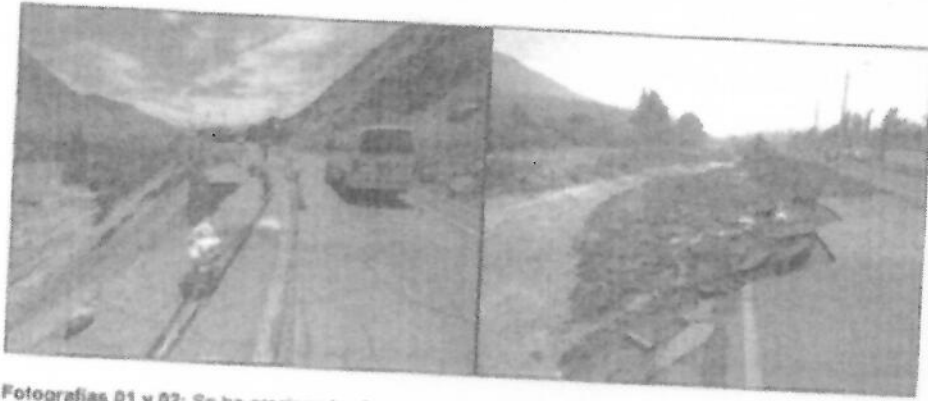
Fotografías 01 y 02: Se ha erosionado el pie del talud ocasionando la pérdida de la plataforma de la vía por incremento del caudal del río.
