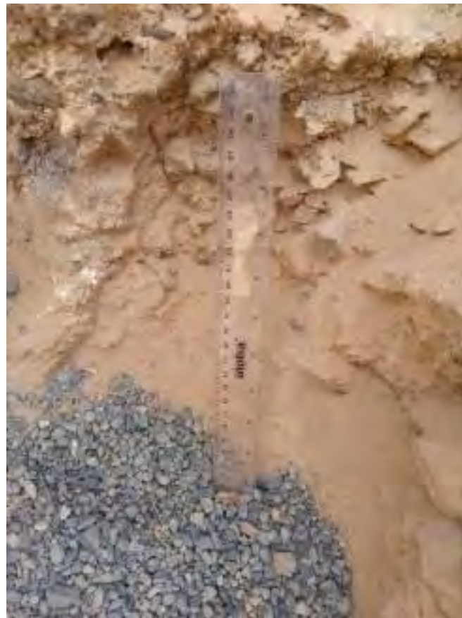
Foto 2. Colocación de la capa de grava para el inicio del test de percolación en la calicata N.º 01
