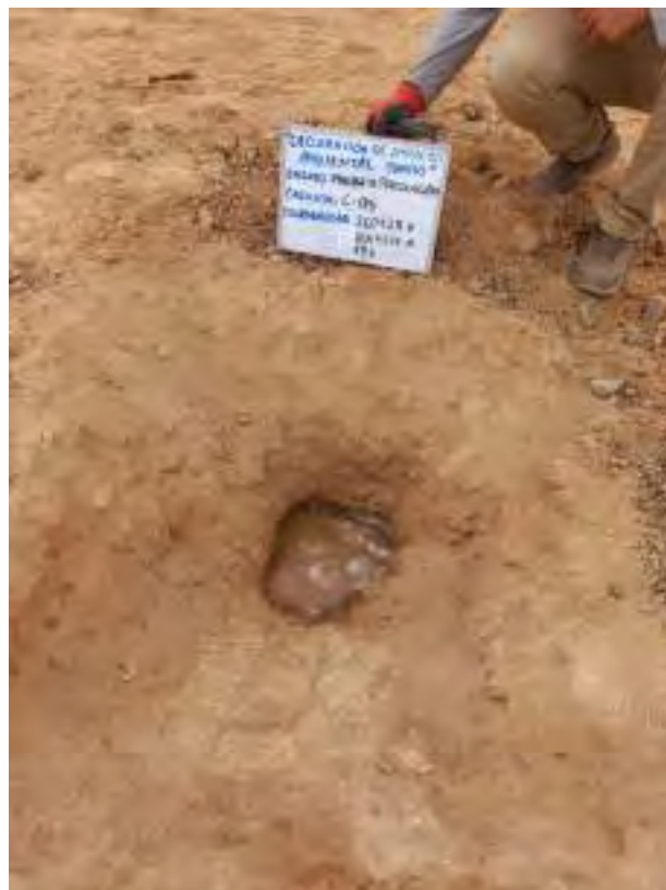
Foto 14. Saturación del agujero antes de iniciar la medición de descenso del nivel de agua en la calicata N.º 05
