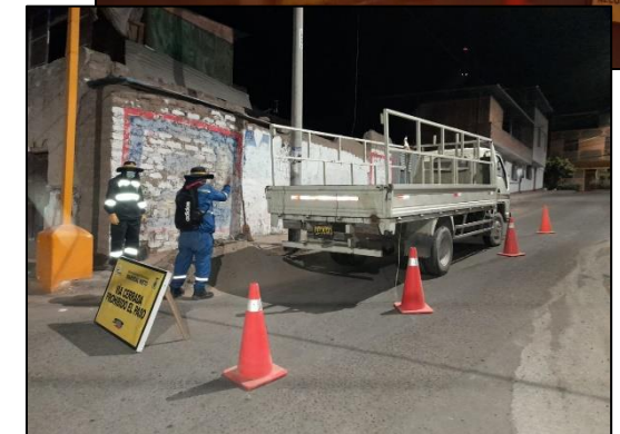
ACUMULACIÓN, ACARREO Y ELIMINACIÓN DE MATERIAL RESIDUAL EN VÍAS
