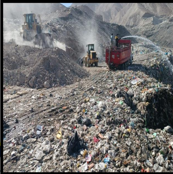
FIG. N°13: CONTROL DE POLVO MEDIANTE RIEGO CON AGUA.
